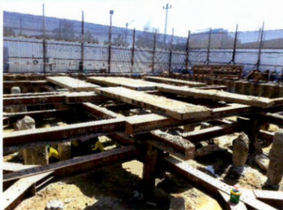
ภาพแสดงงานการติดตั้ง Bracing และ Strut ระบบป้องกันดินพังถล่มเก็บน้ำใต้ดิน
