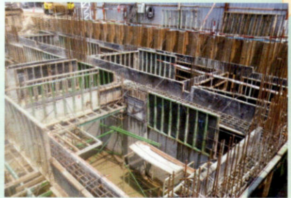
ภาพแสดงการเข้าแบบและผูกเหล็กเสริมคาน ผนังทั้งเก็บน้ำใต้ดิน
