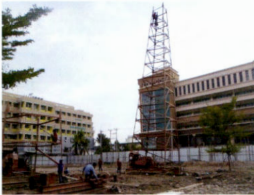
ภาพแสดงการนำบ่อบั่นเข้าประกอบในพื้นที่ก่อสร้าง
