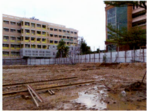
ภาพแสดงการปรับระดับพื้นที่ก่อสร้าง เพื่อเตรียมวางผังตอกเสาเข็ม
